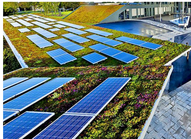
Solarni kolektori na zelenom ravnom krovu
